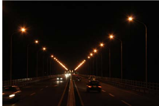
شکل 16: طرح روشنایی پل آستانه لاهیجان با استفاده از پایه ها
